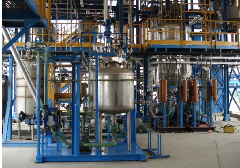
Dettaglio del primo impianto di Vuzeta costruito a Costa dè Nobili in provincia di Pavia (Foto archivi Vuzeta)
